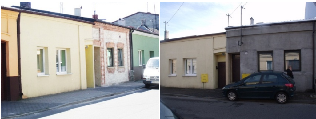
Mstów zmodernizowany dom przy ul. Kościelnej 12, podzielony na dwie oddzielne części. Widoczna pozostałość bramy przejazdowej, przebudowanej na dwoje drzwi. Po lewej stan z 2012 r, po prawej 2019 r.
