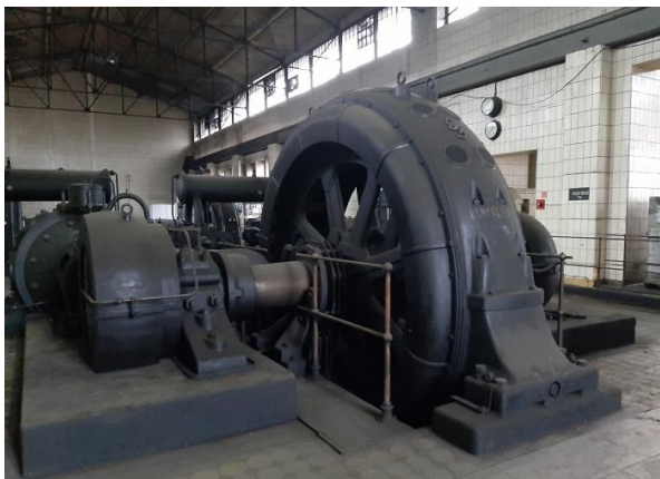
Fotografia 21. Wnętrze budynku siłowni energetycznej z urządzeniami
