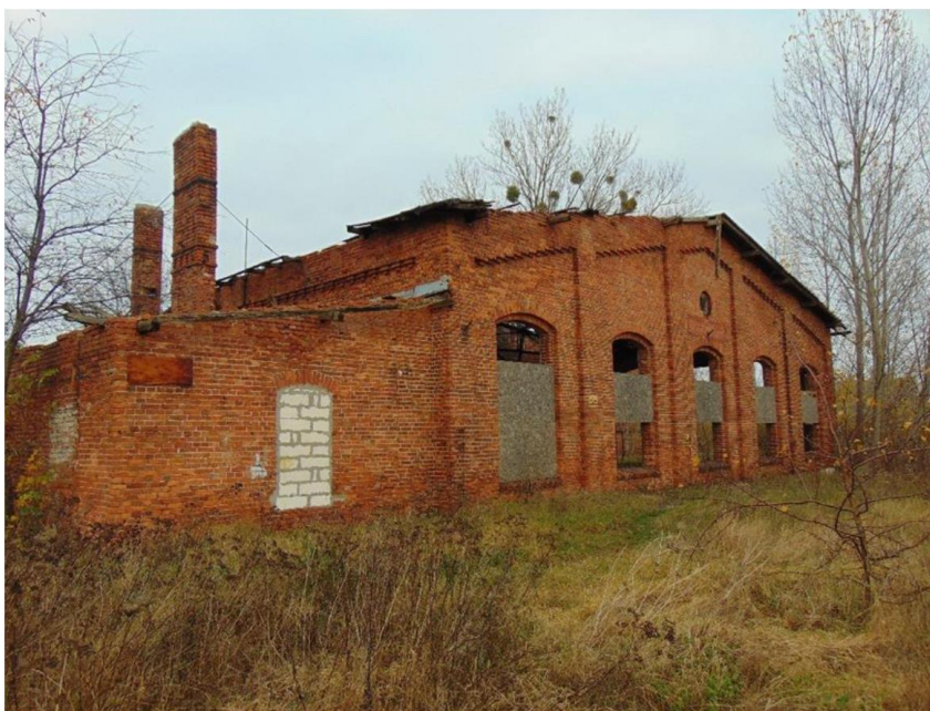
Ryc. 45. Grożący zawaleniem budynek dawnej lokomotywowni w Golańczy, fot. J. Linetty (2023).
