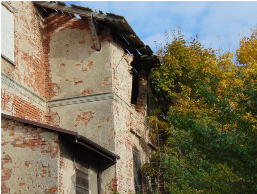
Ryc. 8. Zniszczone okiennice, mury i zadaszenie dworu Karola Libelta w Czeszewie, fot. J. Linetty (2023).
