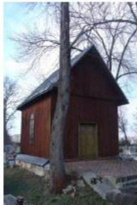
Kaplica przed remontem
