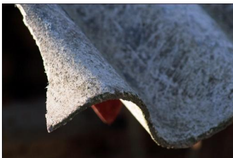
Zdjęcie 7 Płyty faliste azbestowo-cementowych
