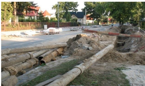
Zdjęcie 9 Rury azbestowo – cementowe
