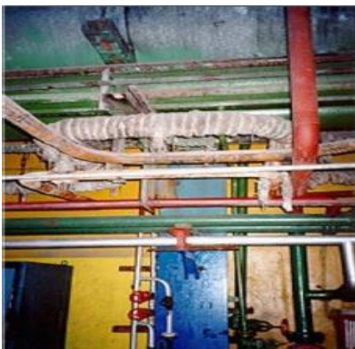
Zdjęcie 11 Izolacja rurociągów ze sznurów azbestowych w elektrociepłowni.
