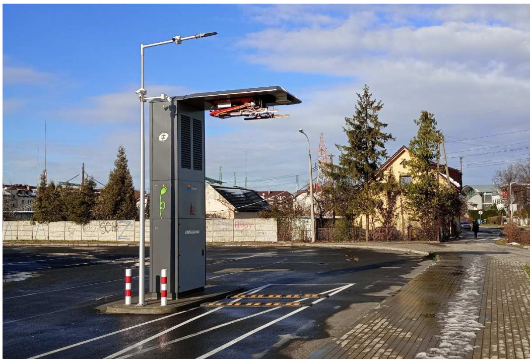
Rysunek 2-17 Stacja ładowania miejskich autobusów elektrycznych w Opolu przy ul. Pużaka
