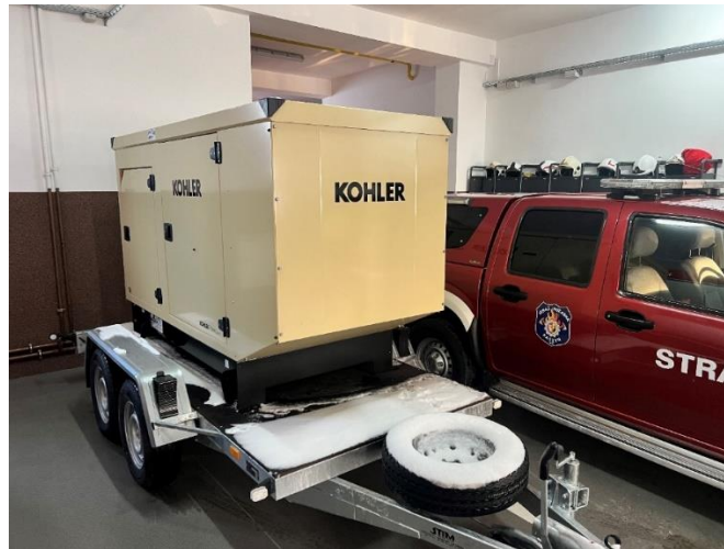
Ochotnicza Straż Pożarna w Raszynie otrzymała dofinansowanie na zakup nowego agregatu prądowłórczego wraz z przyczepką do jego przewozu
