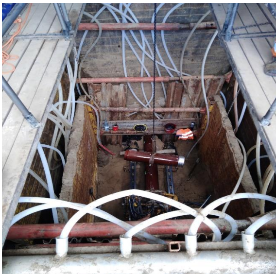
Budowa kanału ściekowego w ul. Obok Sadu wraz z odcinkami sieci od kanału głównego do granic nieruchomości na terenie Dzielnicy Wilanów w Warszawie
