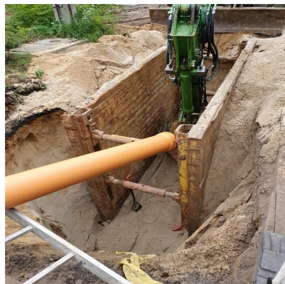
Budowa sieci kanalizacji ściekowej w ul. Śnieguliczki wraz z odcinkami sieci w Warszawie na terenie Dzielnicy Wawer
