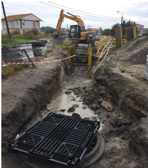
Budowa sieci kanalizacji sanitarnej w ul. Pozytywki wraz z odcinkami sieci od kanału głównego do granic nieruchomości na terenie Dzielnicy Ursynów w Warszawie
