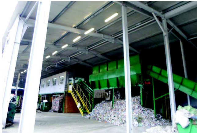
Działająca linia do sortowania odpadów komunalnych w miejscowości Lucin.
