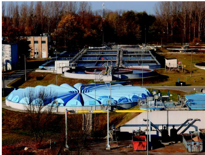
Oczyszczalnia ścieków w Chrzanowie Dużym zmodernizowana ze środków POIiŚ w ramach projektu nr POIS.01.01.00-01-105/13.
