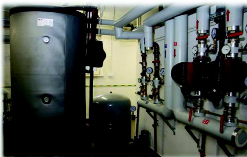
Modernizacja węzła ciepłego w budynku Komisariatu Policji Warszawa Targówek - zadanie realizowane przez Komendę Stołeczną Policji w Warszawie.
