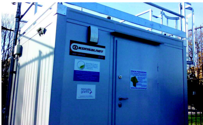
Stacja pomiarowa sieci monitoringu środowiska w województwie mazowieckim zakupiona w ramach zadania realizowanego przez Wojewódzki Inspektorat Ochrony Środowiska w Warszawie.
