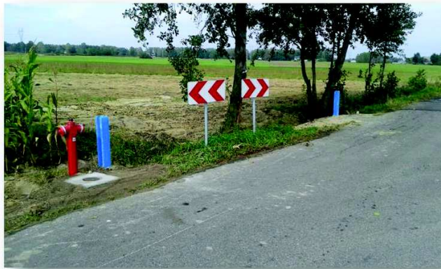
Budowa sieci wodociągowej wraz z przyłączami w miejscowości Lasków, Ludwinów, Chruściele, gmina Dąbrówka.
