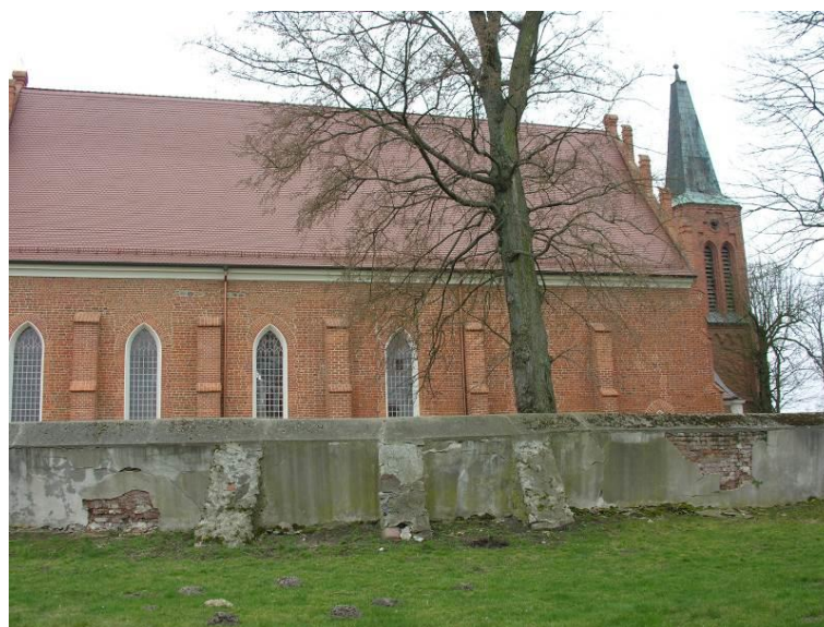
Ogrodzenie kościoła w Pszczonowie wymagające przeprowadzenia działań naprawczych
