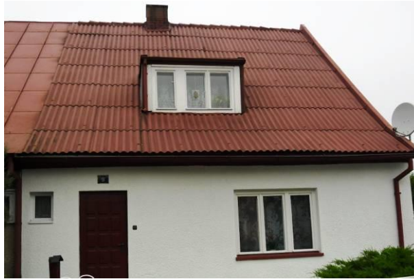
Rys. 6. Pokrycie dachowe ocenione w III stopniu pilności.
