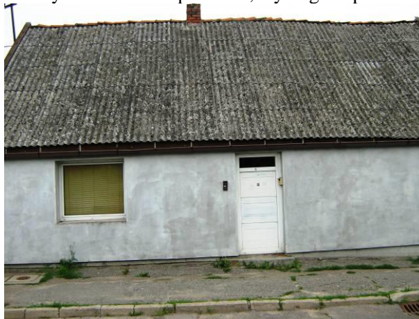
Rys. 7. Pokrycie dachowe ocenione w II stopniu pilności.
