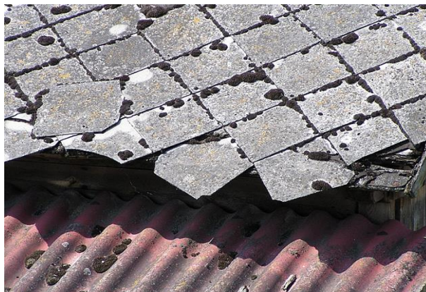
Rys. 8. Pokrycie dachowe ocenione w I stopniu pilności.
