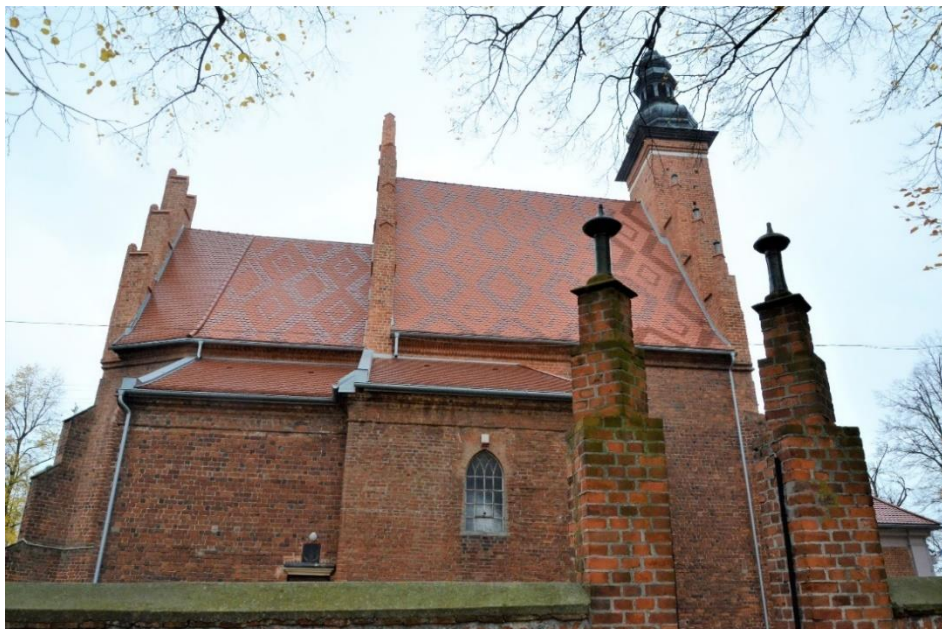
Stan zachowania - 2012 r.
