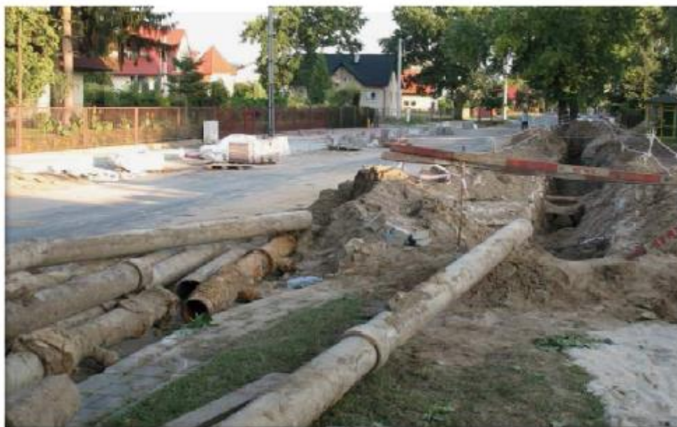
Zdjęcie 6. Rury azbestowo-cementowe.
