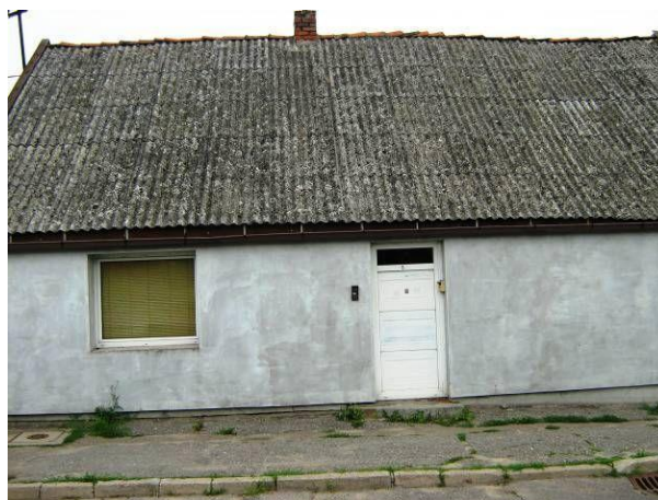
Rys. 11. Pokrycie dachowe ocenione w II stopniu pilności.
