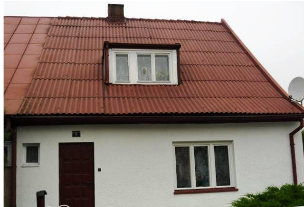
Rys. 10. Pokrycie dachowe ocenione w III stopniu pilności.
