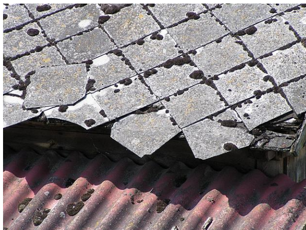
Rys. 12. Pokrycie dachowe ocenione w I stopniu pilności.
