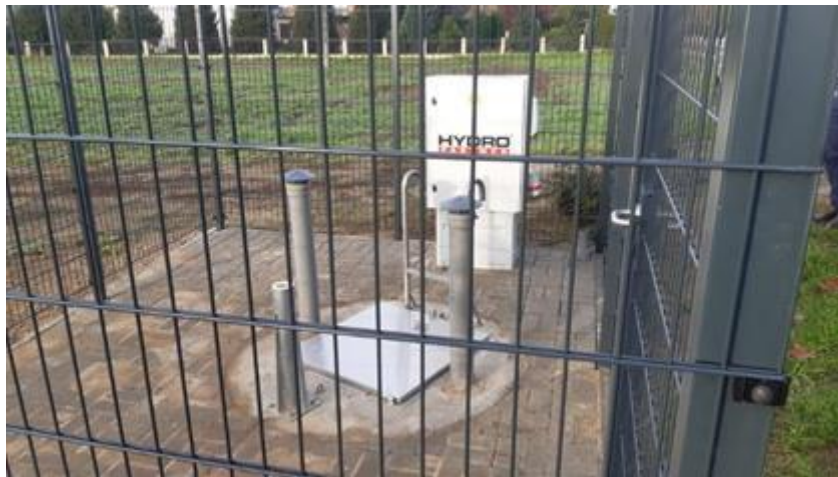
Zdjęcie nr 19 Przepompownia ścieków Lubiszyn ul. Leśna
