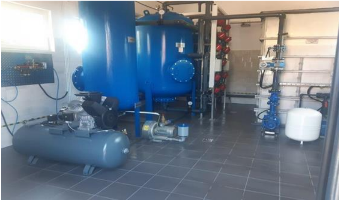
Zdjęcie nr 1 Stacja Uzdatniania wody SUW Staw
