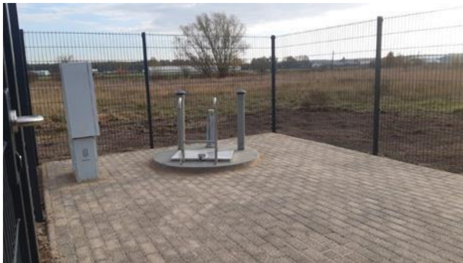
Zdjęcie nr 20 Przepompownia ścieków Lubiszyn ul. Dworcowa
