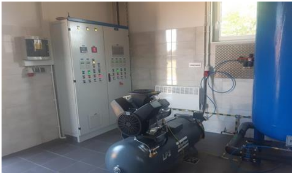
Zdjęcie nr 2 Stacja Uzdatniania wody SUW Staw
