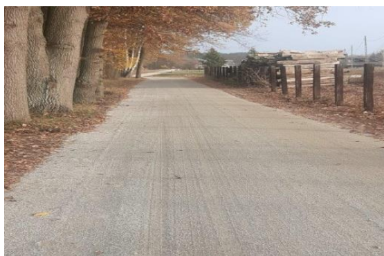
Zdjęcie nr 15 Droga gminna nr 002824F w Brzeźnie
