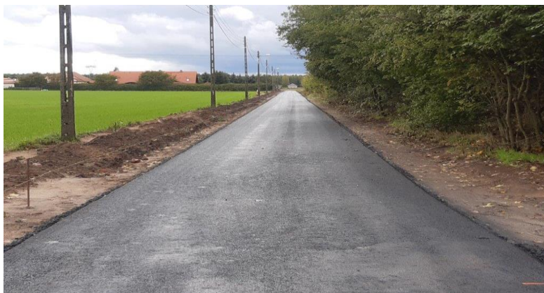
Zdjęcie nr 13 Droga gminna nr 002836F w Wysokiej
