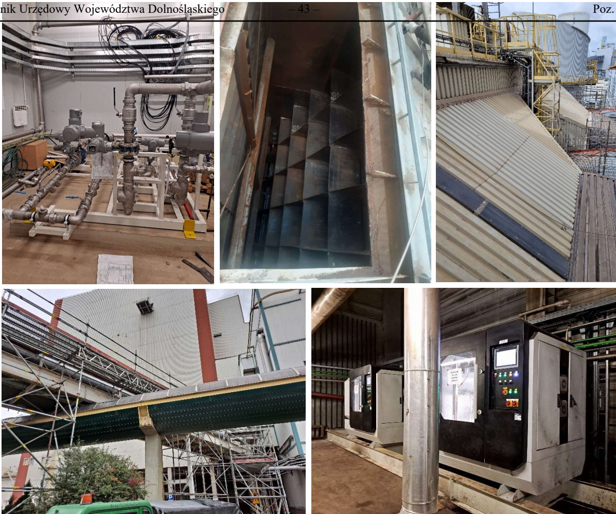
Zdjęcie 4. Rys. Dostosowanie jednostek wytwórczych PGE GiEK S.A. Oddział Elektrowni Turów do konkluzji BAT w zakresie redukcji emisji rtęci na blokach 1-6 oraz w zakresie redukcji emisji pyłu na blokach 4-6 - PGE Górnictwo i Energetyka Konwencjonalna S.A.
