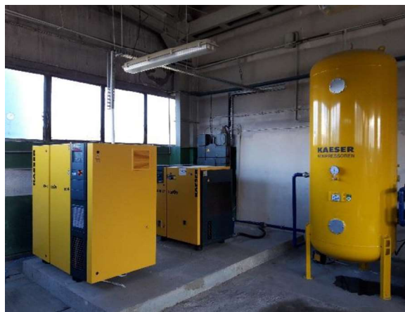
Rysunek 6. Poprawa efektu energetycznego Zakładów Ceramicznych „Bolesławiec” Sp. z o.o. poprzez modernizację instalacji wytwórczej sprężonego powietrza oraz modernizację oświetlenia
