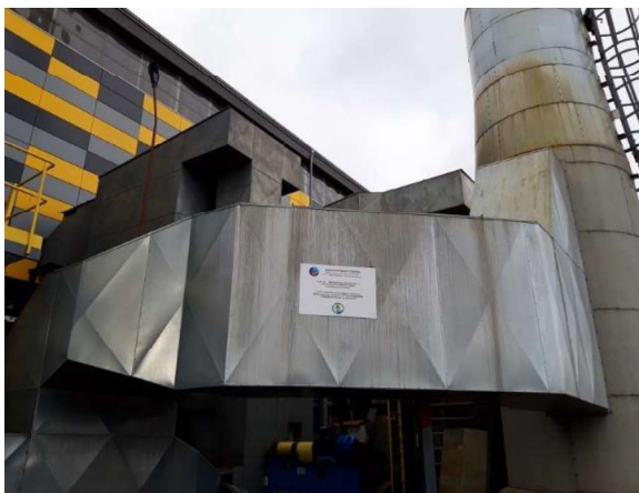
Rysunek 5. Modernizacja kotła WLM5 wraz z instalacją odpylania spalin w Ciepłowni Centralnej oraz rozbudowa i modernizacja systemu ciepłowniczego miasta Bolesławiec, ZEC Bolesławiec
